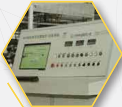
Equipos de prueba hidrostática
